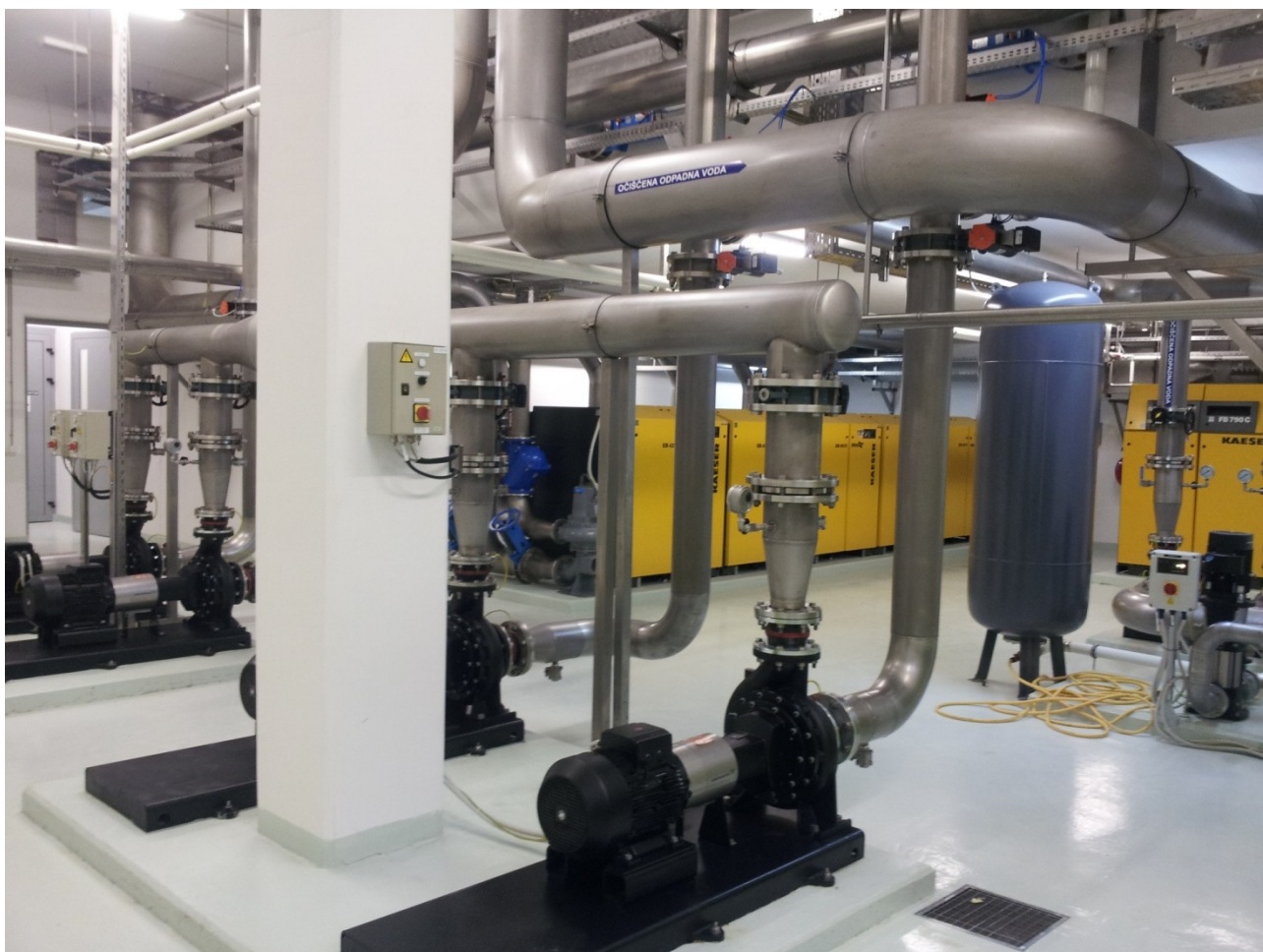
Pogled na strojnico biološko filtracijskega dela KČN Novo mesto
